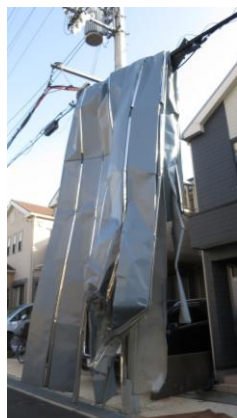
吹き飛んだ屋根鋼板
