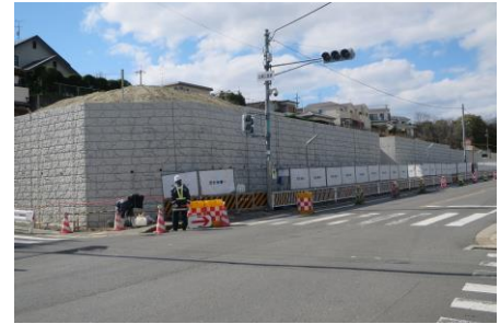
以楽公園付近の擁壁、角切りが行われた
