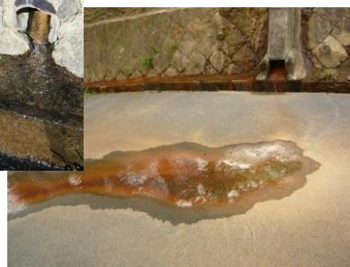
道路に常時浸出している水
