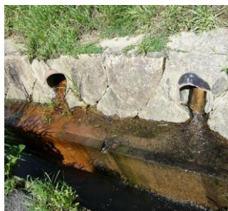
石垣からの流水
